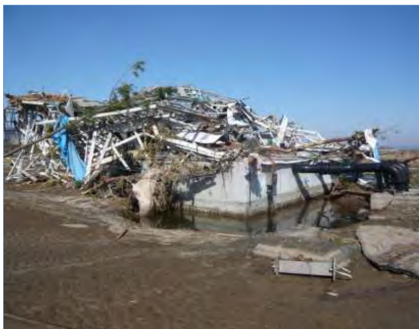
津波により全損した山下第8揚水機場
