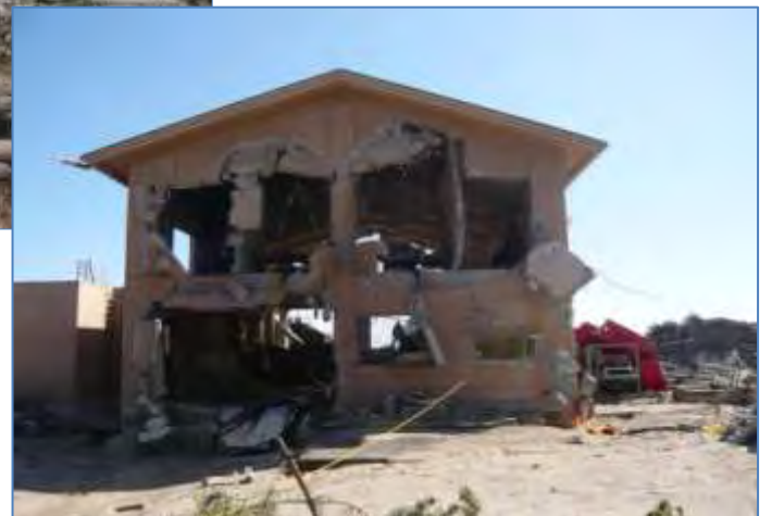
破壊された花笠第2排水機場
