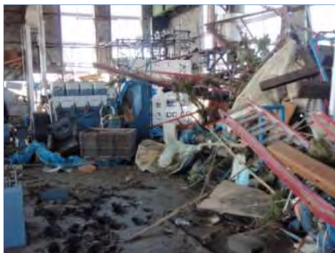
被災した荒浜排水機場内部
