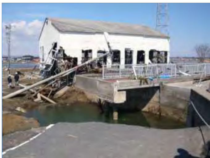
破壊された荒浜排水機場・・・③
