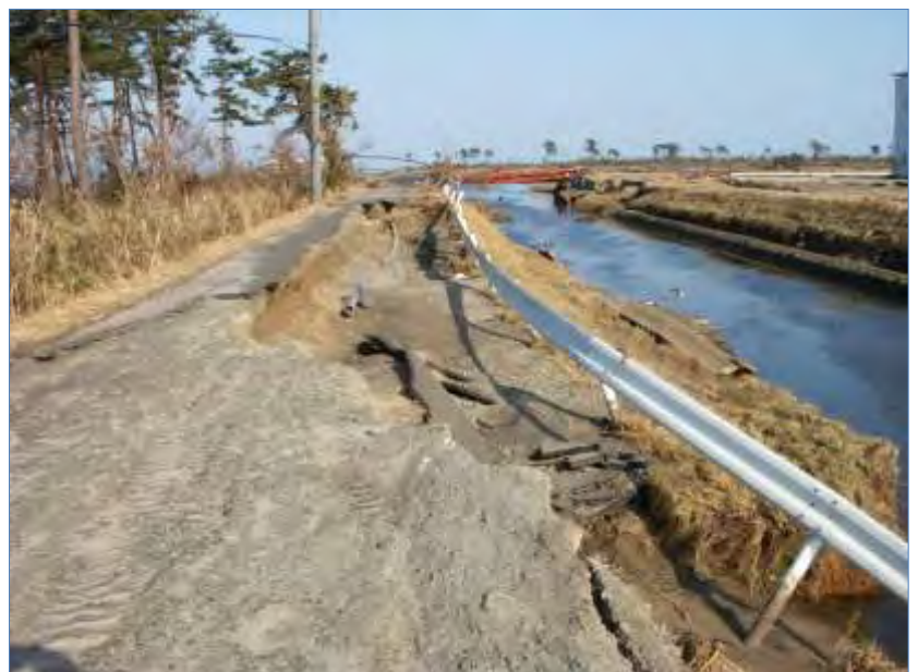
地震及び津波により堤塘が破壊された 落し堀排水路・・・⑭
