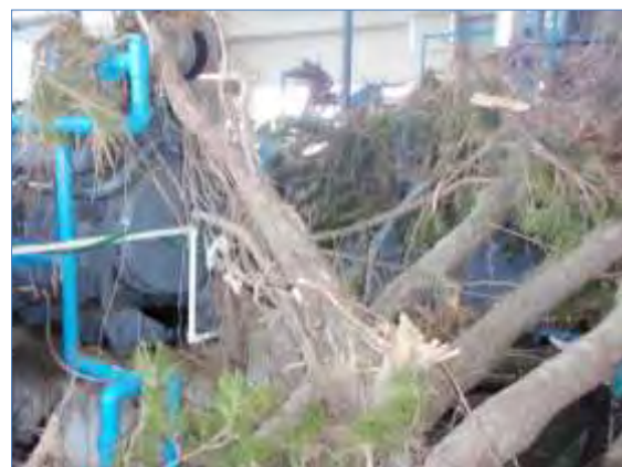
雑木や土砂、ゴミが流入した排水機場内部
