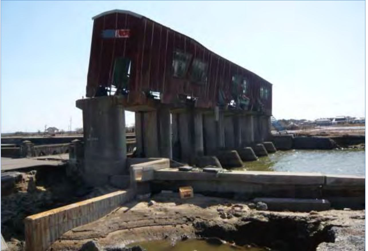
破壊された鯉川防潮樋門・・・⑩
