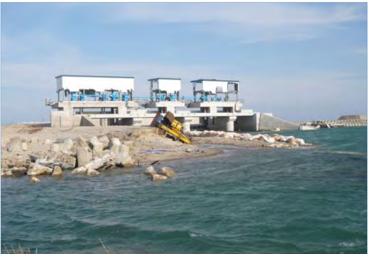
破壊された牛橋防潮樋門・・・⑪
